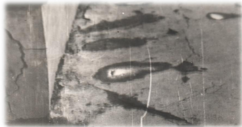
Рис.1 Трещины, образовавшиеся в цокольной части здания
