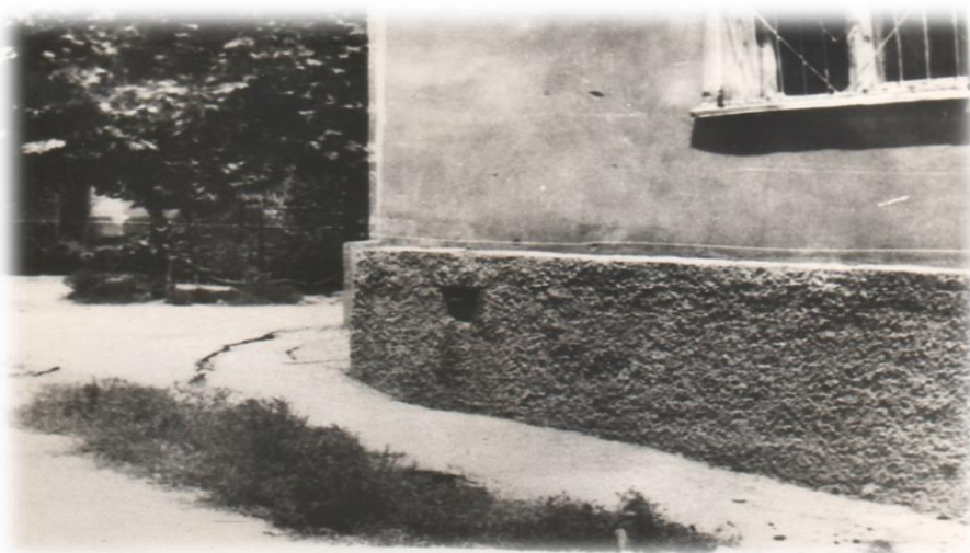
Рис.2 Деформация переувлажненных насыпных грунтов вокруг дома
