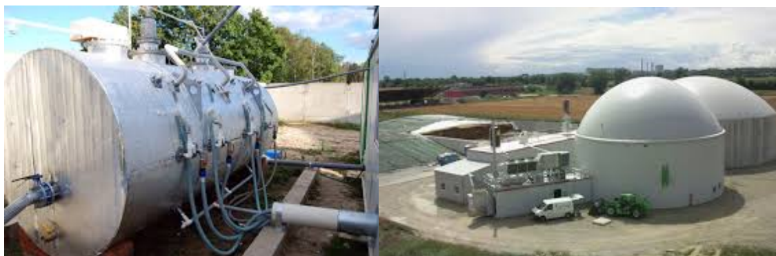
23-rasm. Biogaz qurilmalari.
